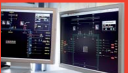
Übergabe der errechneten Übertragungskapazitäten an das Netzleitsystem
